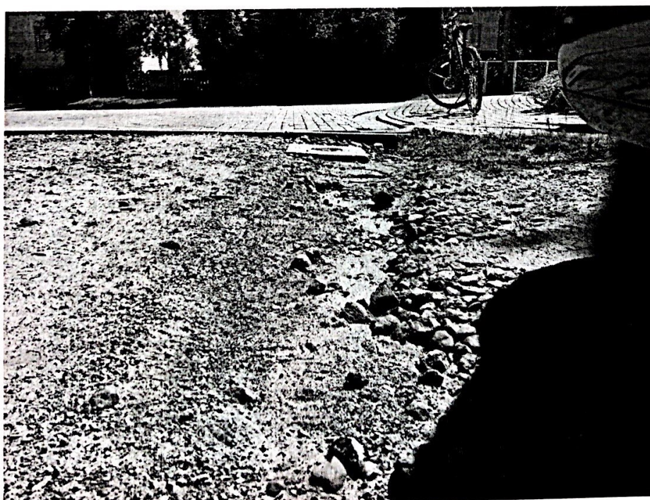
Rys. 2 Ubytek prawej strony ul. Jesionowej wraz z zapadniętą studzienką gazową
