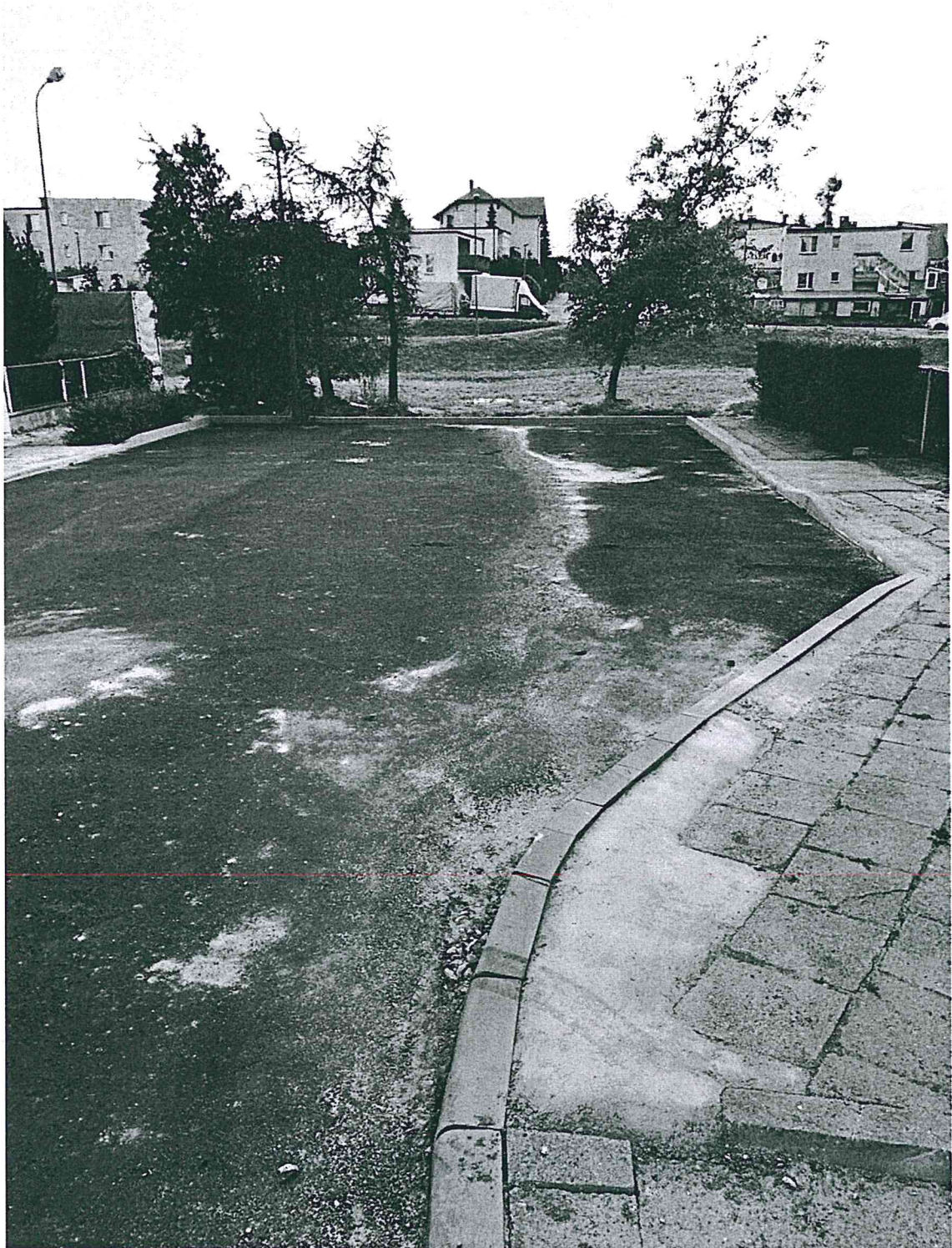
Zdjęcie nr 3 – łąty betonowe w powierzchni chodnika oraz nierównomiernie utwardzona droga
